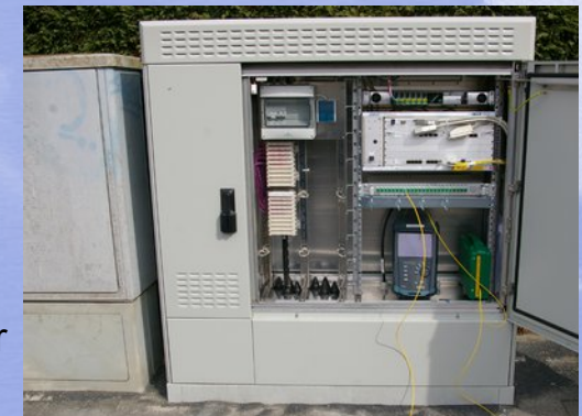
Multifunktionsgehäuse als Nachfolger des Kabelverzweigers
